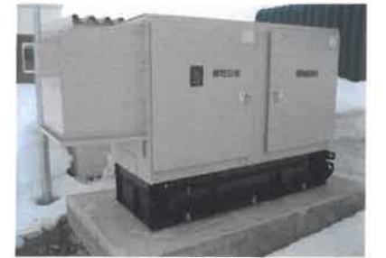
非常用発電機システム
